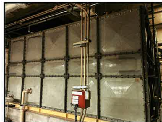
受水槽の外観(定水位弁・パイロット管は受水槽右側)
