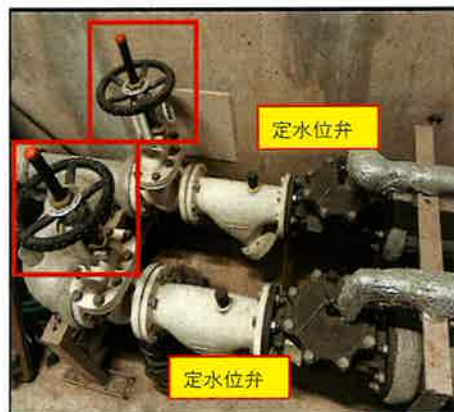
定水位弁・仕切弁 図3
