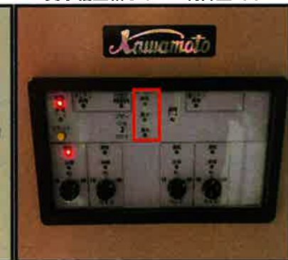
受水槽室給水ポンプ制御盤 図2
